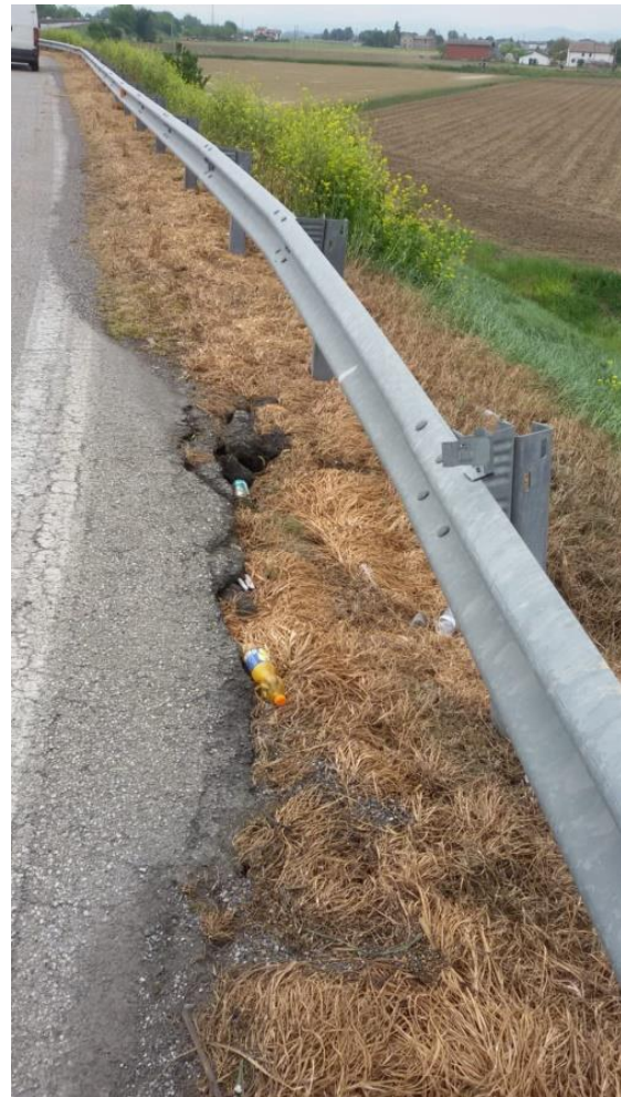
Figura 14: diserbo e cedimento del margine stradale
